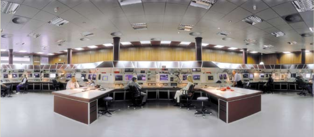
GSI-Infrastruktur – Hauptkontrollraum. Von hier wird die gesamte Beschleunigeranlage der GSI gesteuert.
